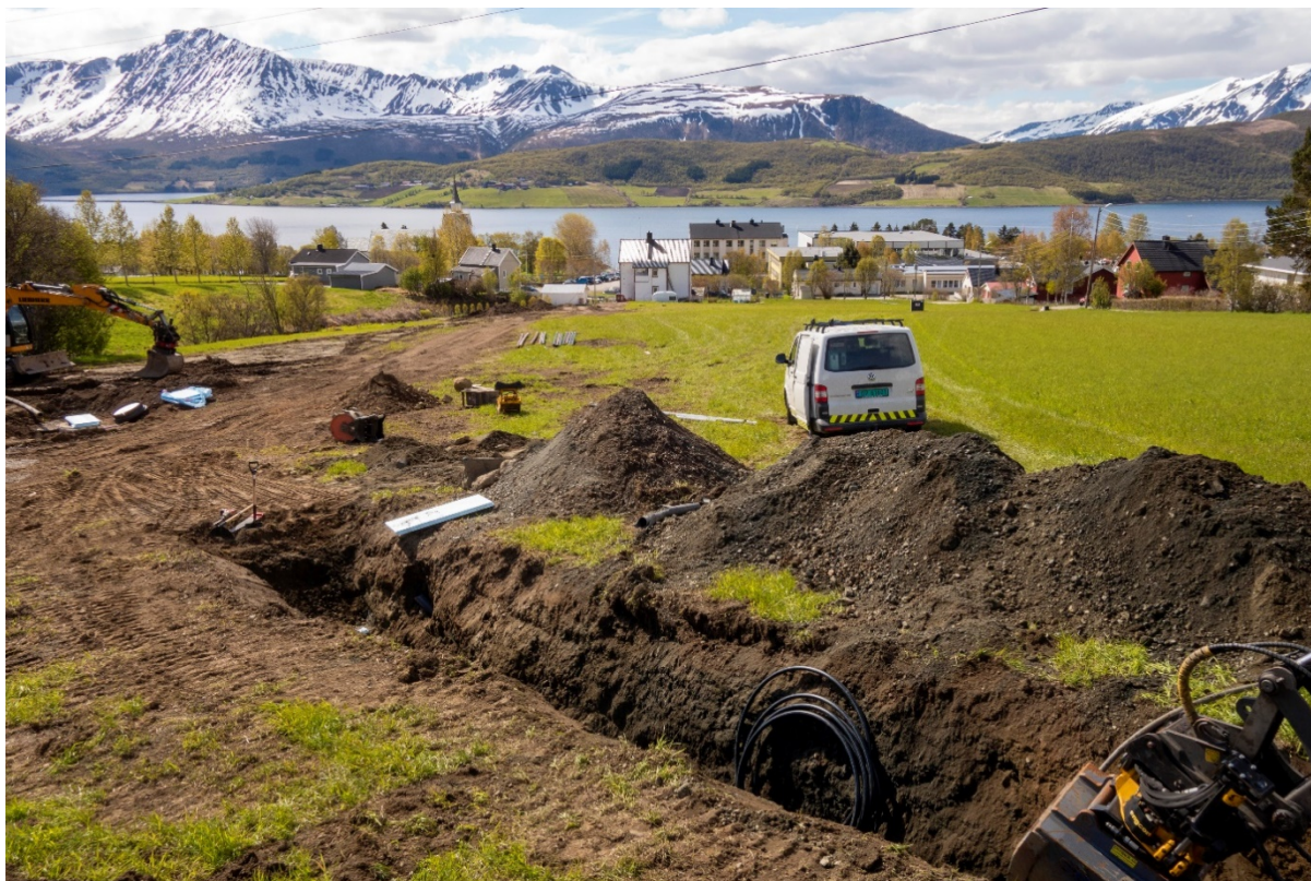
Figure 2 Situasjonen slik den framstod da arkeolog ankom. Gravemaskin hadde fulgt gammel trase fram til noen meter utenfor sikringssonen til objektet.
