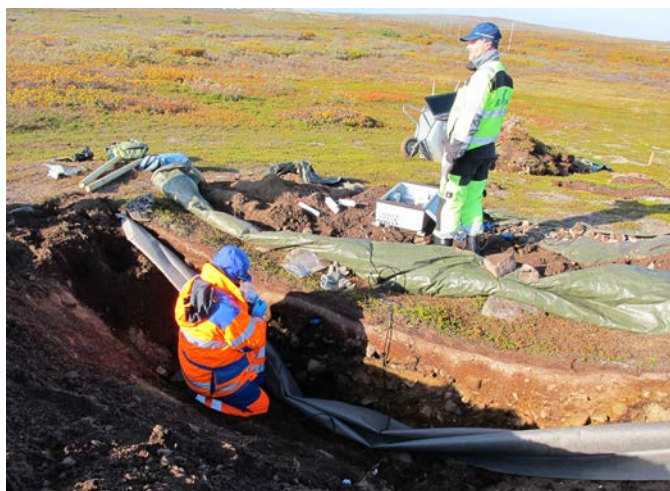
Figur 80 Installasjon av overvåkingssutstyr i Tuft 1 på id. 18734. 19.9.2014
